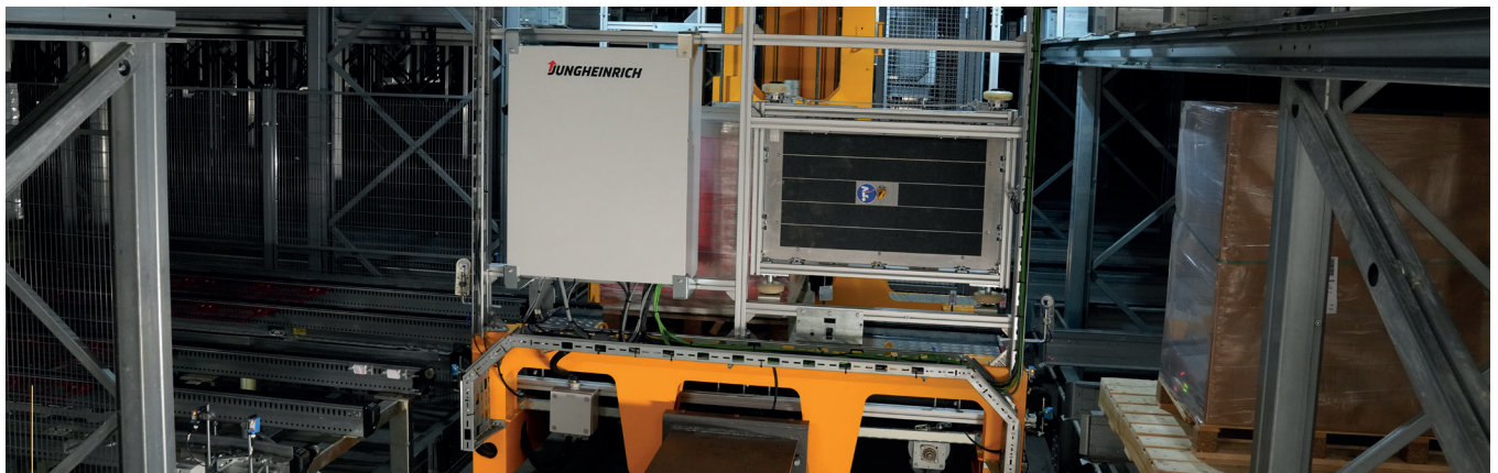
De twee 33,5 meter hoge kranen zijn voorzien van een dubbel diepe shuttle zodat ook palletten van 1.200 x 2.400 mm in het systeem passen.
