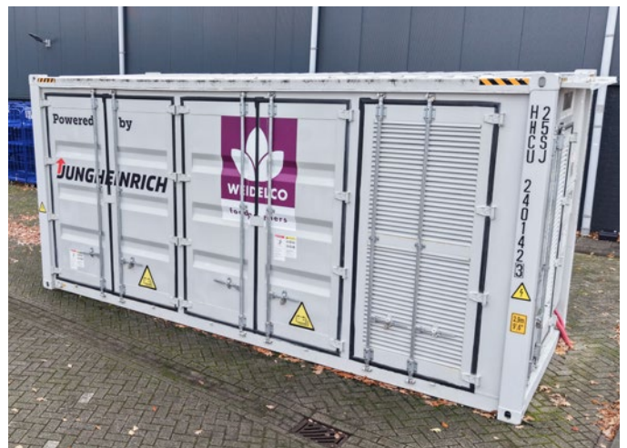
Het Energie Opslag Systeem van Weidelco is het eerste in deze vorm in Nederland en biedt voor de groothandel dé oplossing voor het netcongestie-probleem.
